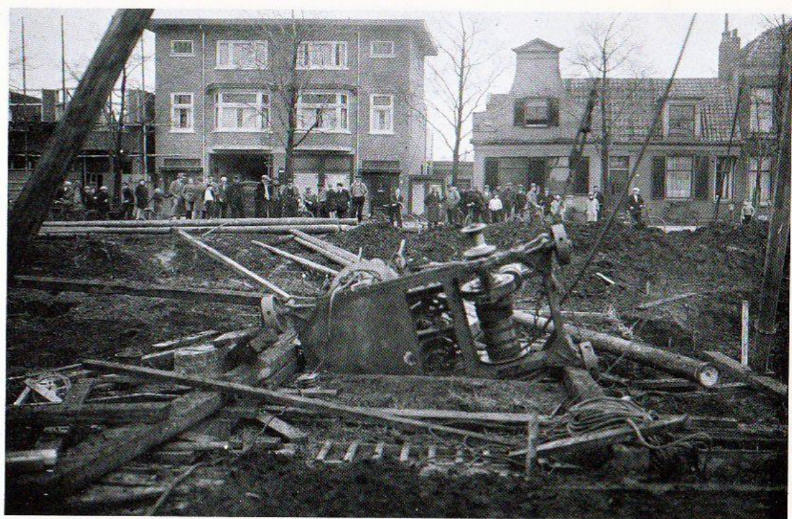
De ravage na het omvallen van de heistelling in de Westzijde.
